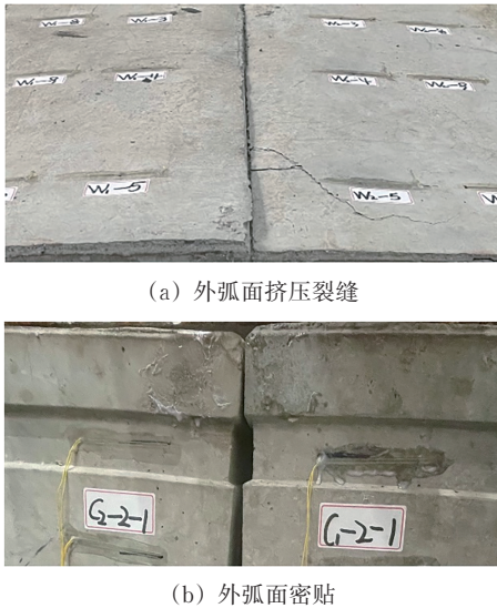
图6 接头整体破坏阶段管片实况
