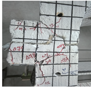
(a) 侧墙 1 和拱顶 1 榫头连接处
