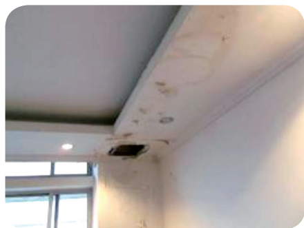
图4 平顶房房顶漏水照片
