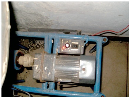
图2 电动机、减速器和配电箱
