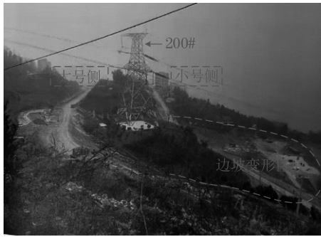
图2 200#塔边坡变形实景
