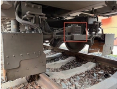
图 4 惯导装置安装位置
