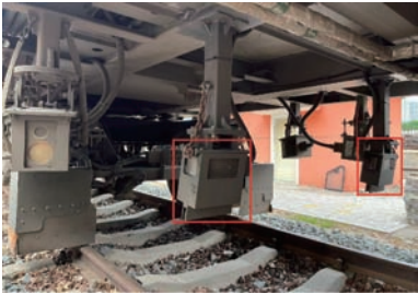
图 2 巡检相机安装位置
