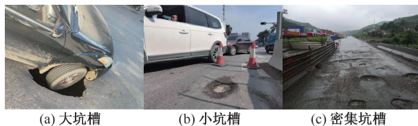
图1 路面坑槽病害
