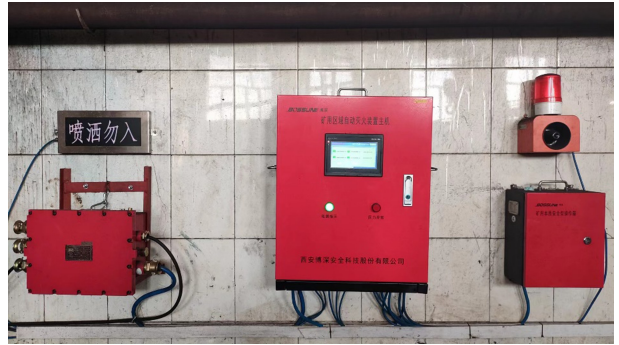
图2 防火灭火装置
