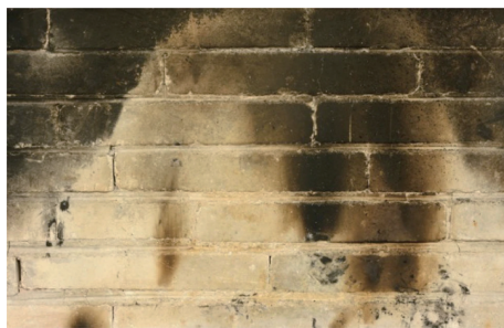
图 2 火灾现场烟熏痕迹
