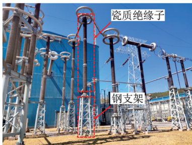
图 1 变电站典型瓷柱型设备
