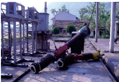
图 2 开关设备的根部破坏
