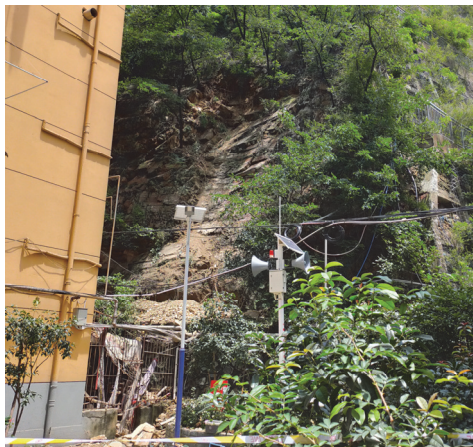
图 21 崩塌现场照片
