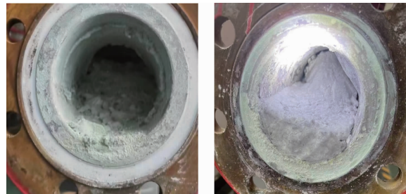
图 9 电解制氟工艺管道粉尘堵塞情况
