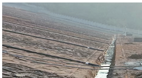
图 3 第二坝段正面排渗管
