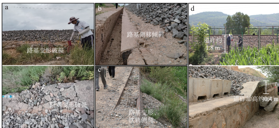
a. 路基变形破坏; b. 路基侧移倾斜; c. 路基变形与轨道侧翻; d. 道砟加高
