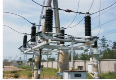
图 2 户外高压隔离开关设备实况
