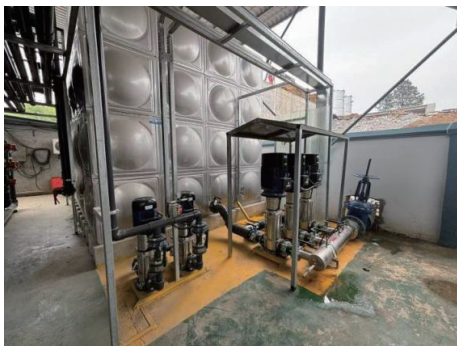
图 13 软水水箱 Fig. 13 Soft water tank
