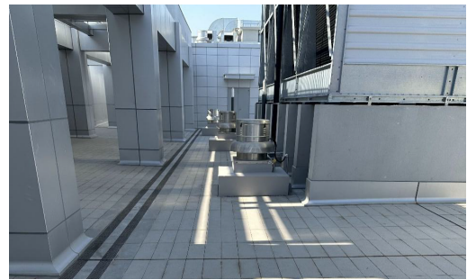
图 11 项目 A 中某设备实际检修空间
