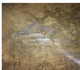
图1 底板上涂层破损、脱落图
