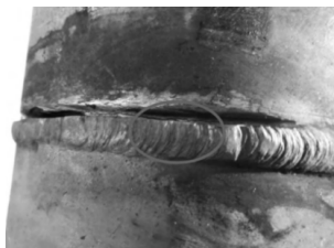
图 1 磁粉检测中常见的贯穿性裂纹
