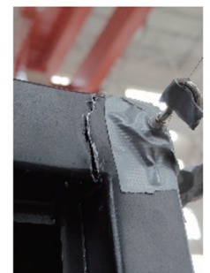
(m) 前门梁柱节点焊缝裂缝贯通
