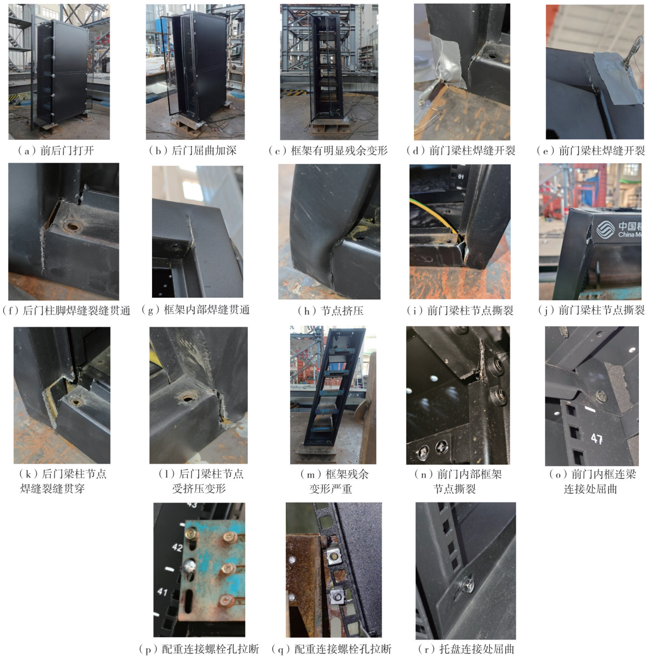
图6 2号机柜损伤现象
