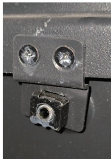
(b) 侧板连接构件变形
