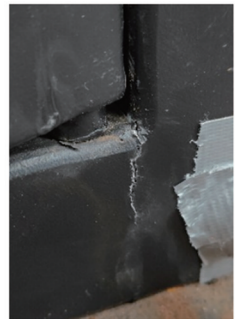
(e) 前门梁柱节点焊缝开裂
