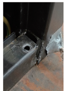
(l) 前门梁柱连接焊缝裂缝贯通
