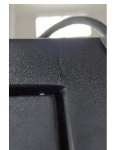
(o) 后门梁柱节点焊缝裂缝延伸
