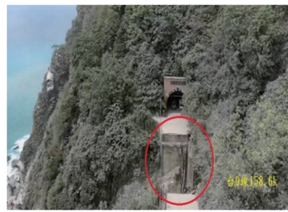
图 19 花莲县秀林乡大清水隧道前桥梁断裂 [61]
