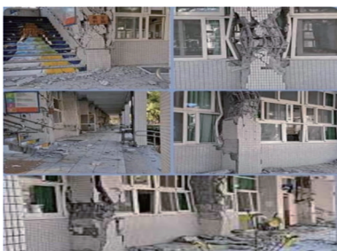
图16 花莲县女子中学校舍内多处墙体发生破坏 [57]
