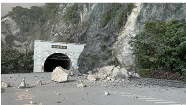
图 12 苏花公路崇德隧道口大量落石 [4]
