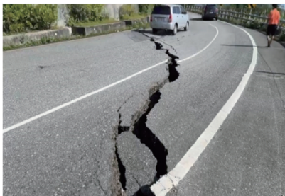
图 20 现场道路发生大破裂 [62]
