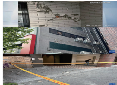
图17 台北市居民楼墙体破坏 [58-59]
