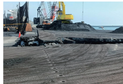
图 21 花莲港西堤 25 号码头陷落 [63]
