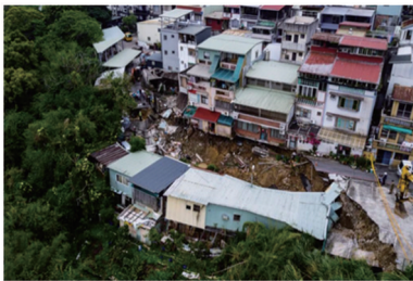
图14 新北市房屋地基塌陷 [56]
