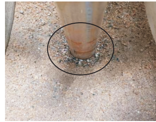
图 4 桥墩冲刷坑底部粗化覆盖层 (RunC6)
