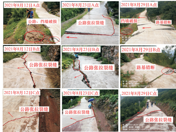
图 8 主要变形区 A、B、C 处路面变形情况
