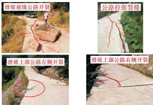
图 6 滑坡公路开裂情况
