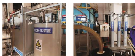
图 2 电化学耦合现场试验装置
