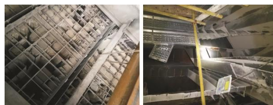
a) 催化剂坍塌照片 b) 导流板磨损照片
