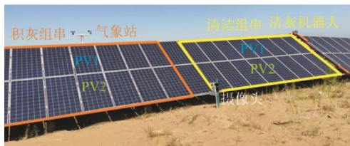
图1 实验台系统实物
