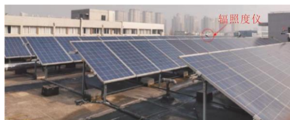
图1 光伏阵列测试平台 Fig.1 Photovoltaic array test platform
