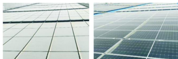
a) 粮油厂屋顶光伏组件积尘 b) 机械厂屋顶光伏组件积尘
