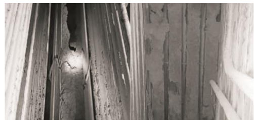
图 3 锅炉受热面结渣
