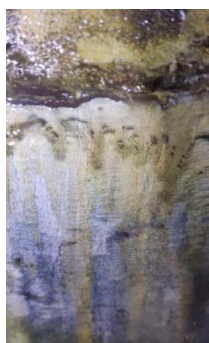
图 6 接管座外表面裂纹形貌
