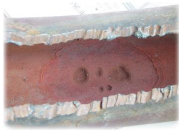
图2 水平段省煤器管氧腐蚀坑
