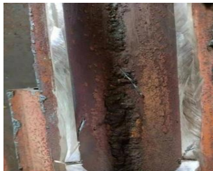
图 20 水冷壁向火侧有原始腐蚀管段管样
