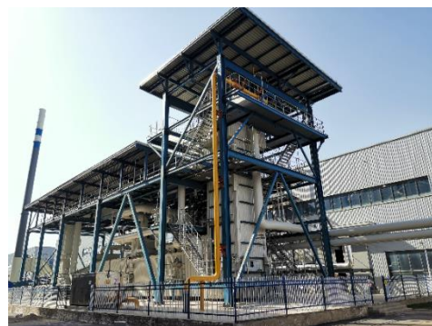
图 1 5 MW S-CO 2 锅炉现场照片 Fig.1 Photo of the 5 MW S-CO 2 boiler
