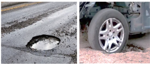
图1 汽车通过路面凹坑场景
