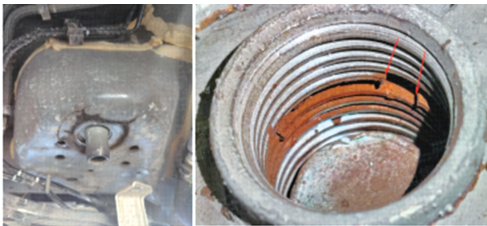
图1 螺栓套外观及断裂位置
