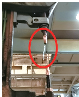
(a)生产现场冷却水泄漏
