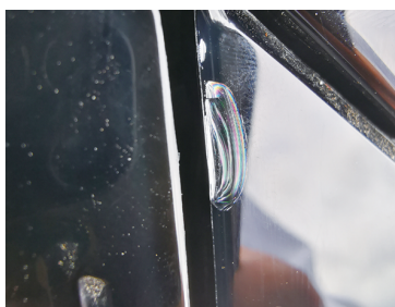
(a)开裂位置
