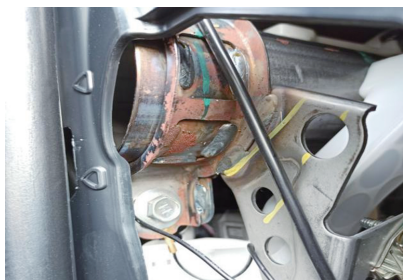
图2 生锈钢制仪表板横梁
