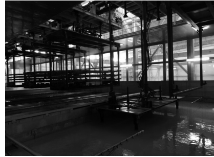
图7 某商用车车架阴极电泳生产线
