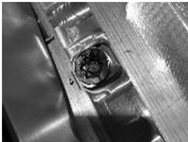
(a)断裂失效螺栓宏观形貌
