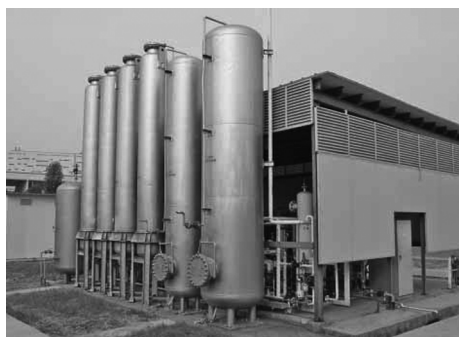
图2 燃料电池示范电站
