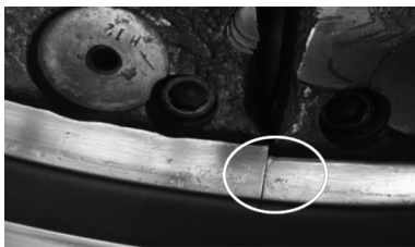
图57 接缝间隙过大
