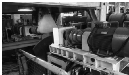
图2 EPS切换后现场清洁干净的设备
