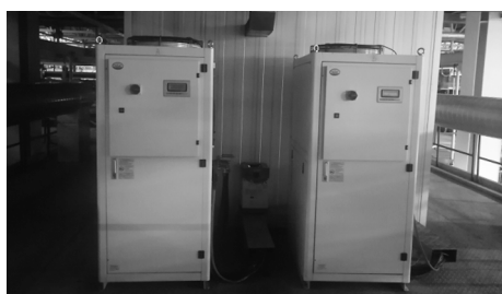
图8 激光器冷却水机组
