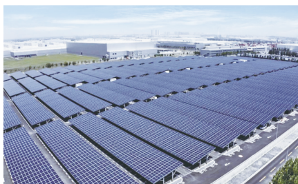
图11 某主机厂房屋顶光伏发电
