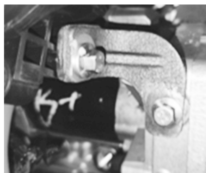
图13 铸铁支架台架耐久测试后状态
