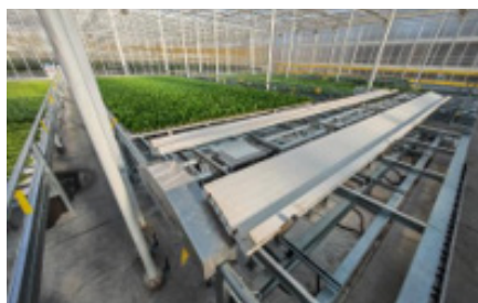
图3 栽培管道运输设备
