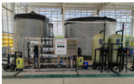
图5 RO水制备系统
