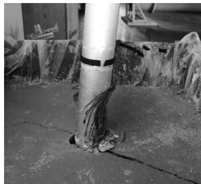
(a)桩右前方明显裂缝
