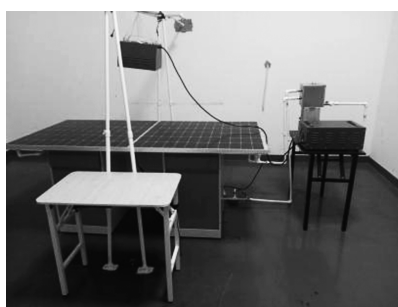
图1 PV/T 系统实验平台 Fig.1 PV/T system experimental platform
