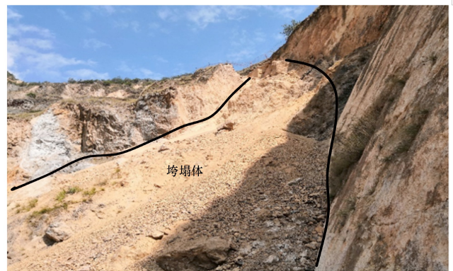
图3 北部边坡断层构造带垮塌
