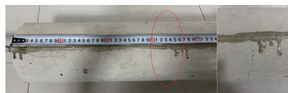
(a) 混凝土上侧表面裂缝
