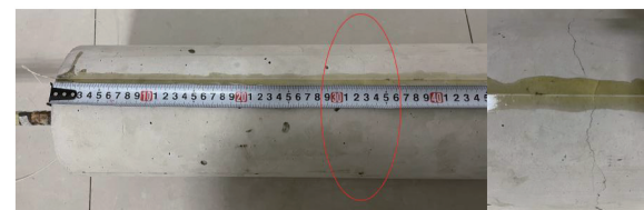
(b) 混凝土下侧表面裂缝
